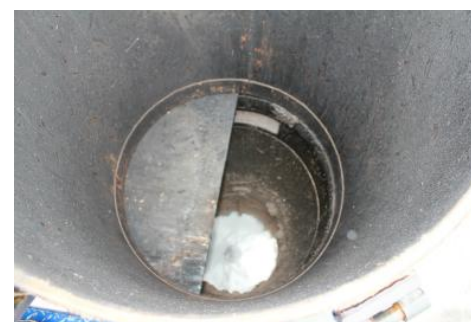
写真2 熱分解炉投入口
