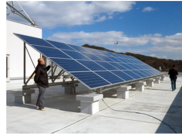
【大槌消防署の太陽光発電設備】
