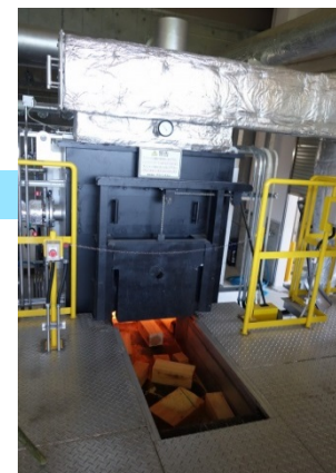
【木質バイオマスボイラー】
