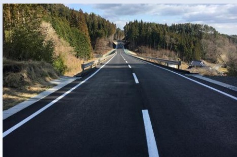
主要地方道 大船渡広田陸前高田線 太陽工区 (H30. 3. 16 開通 陸前高田市)
