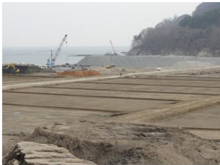
農用地災害復旧関連区画整理事業によるほ場整備工事の様子
