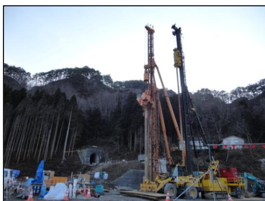
復旧工事中の三陸鉄道北リアス線 (田野畑村 島越駅周辺)
