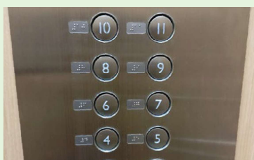
点字により、目の不自由な方への 情報提供を行う案内設備
