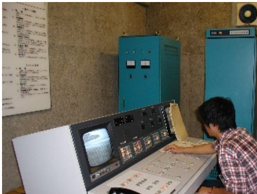
写真 2. 2. 6 田代川水門遠隔操作卓
