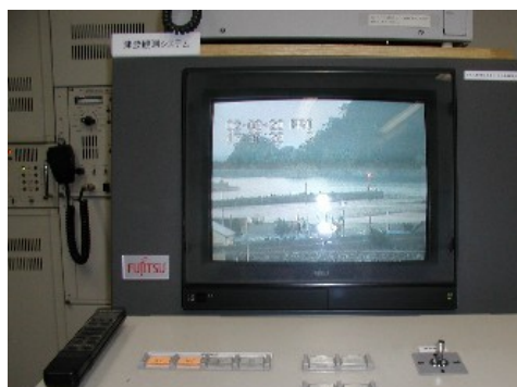
写真2. 2. 3 監視カメラモニター（役場）
