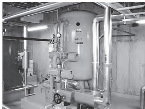
雨水貯留施設（二戸地区合同庁舎）
