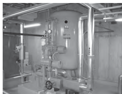
雨水貯留施設（二戸地区合同庁舎）
