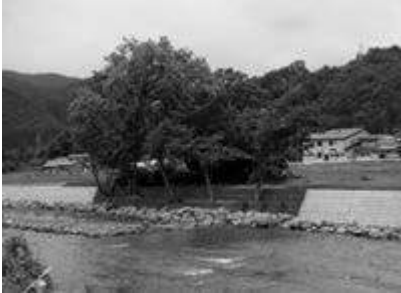
河畔林を保全するため護岸工法に配慮した雫石川（雫石町）
