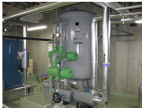
雨水貯留施設（二戸地区合同庁舎）
