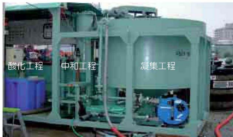
図 8-13 酸化、中和、凝集装置の概況写真
