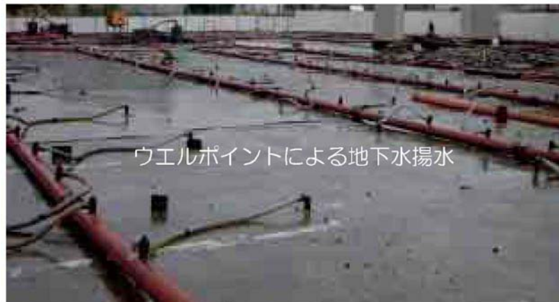
図 8-12 地下水揚水の概況写真
