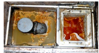
油吸着シートを使用している 7階飲食テナントのグリストラップの状況
