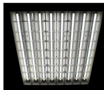
館内の基本照明 (40W8灯タイプ)
