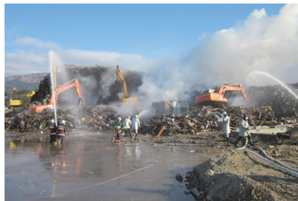
写真 3.4.7 仮置場の火災状況（陸前高田市）
