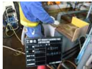
処理水採水状況
