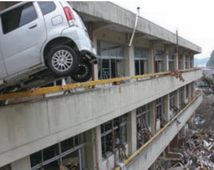
釜石市立鷺住居小学校の校舎(平成23年5月25日)
