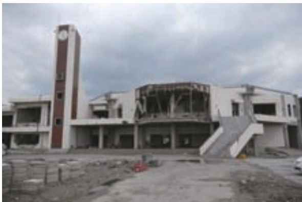
全壊した陸前高田市民体育館(平成24年4月18日)
