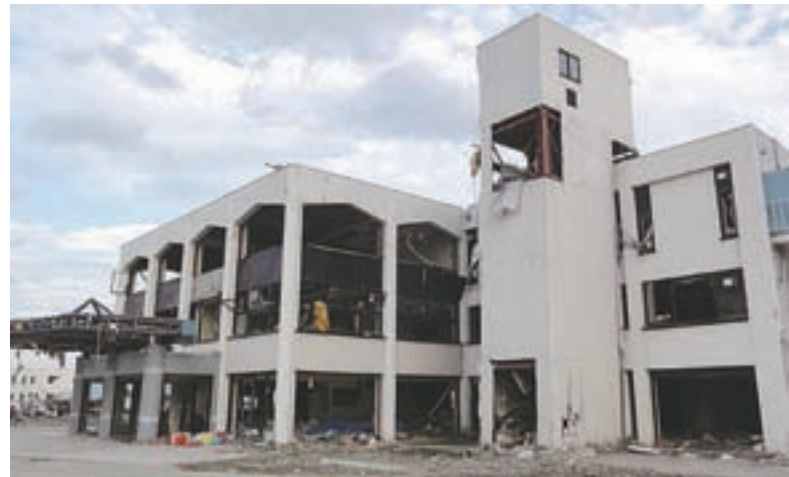
全壊した陸前高田市民会館 岩手県中学校長会提供
