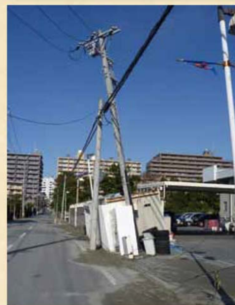
液状化現象によって、 電柱が傾いたり 埋まったりした (千葉県千葉市)
