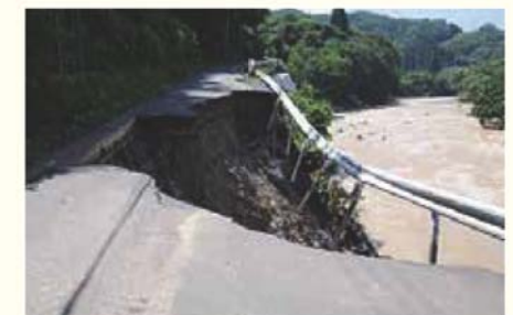
大雨でくずれた川沿いの道路(雫石町)
