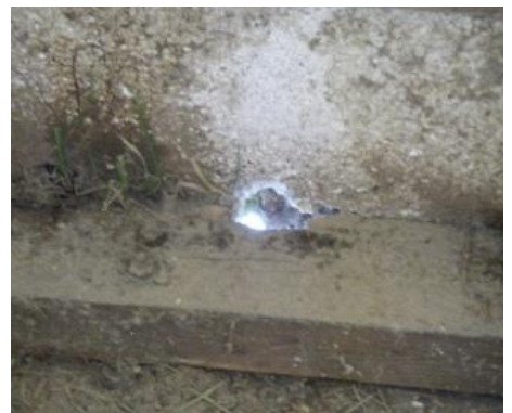
壁の一部破損（床との間に隙間）
