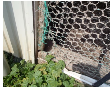
側面に金網の破損（直径約10cm）
