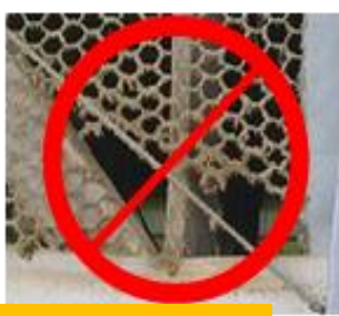
破損は速やかに修繕しましょう
