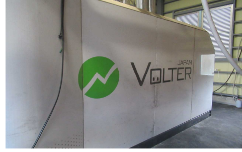
老人福祉施設に導入された 熱電供給システム (紫波町)
