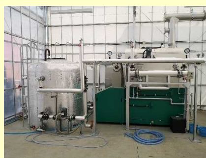
チップボイラー
