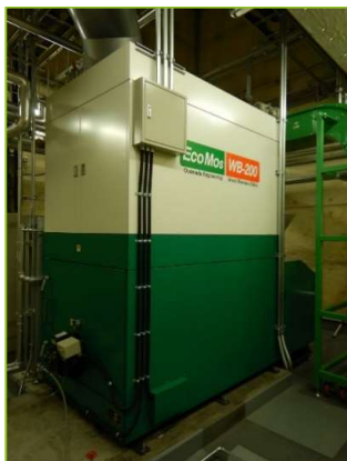
チップボイラー
