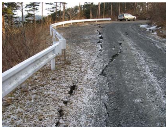
（写真一）五本松峠線の被害状況
