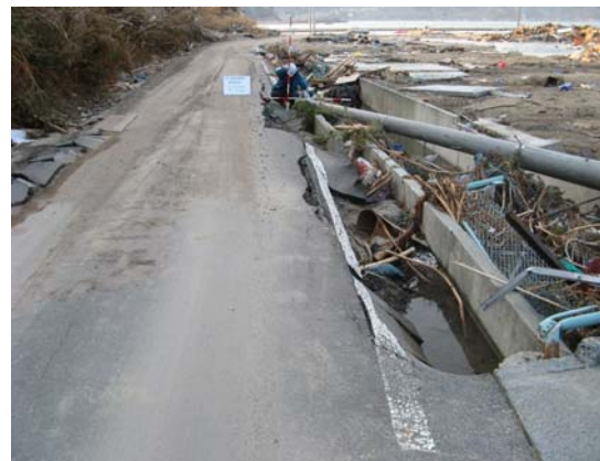
（写真二）吉里吉里線の被害状況
