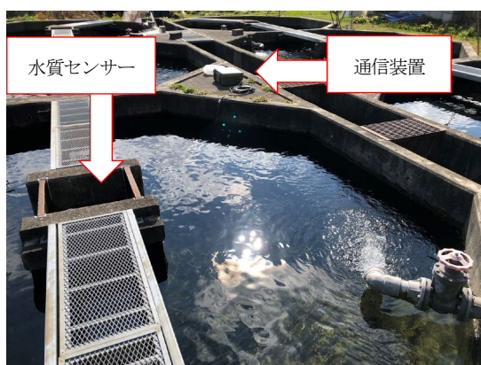
図1 装置の設置状況
