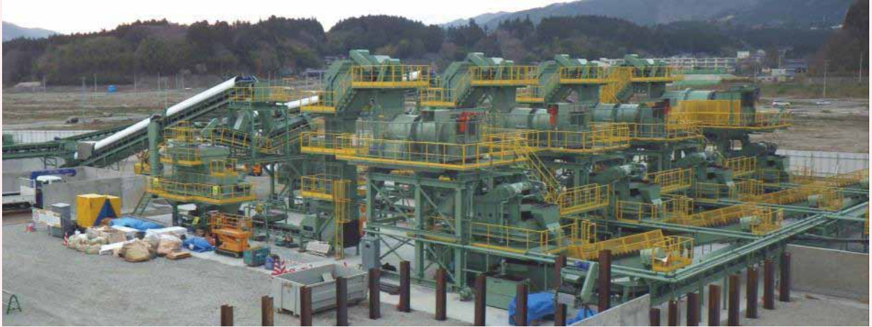
津波堆積物処理装置
