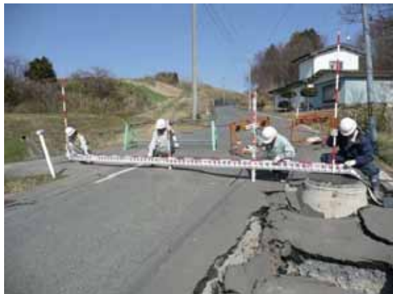
農業集落排水施設のマンホールの隆起（北上市下門岡地区）
