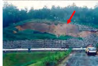
写真 38：堤体付近の法面(崩壊後)
