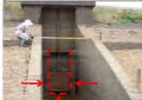
写真 33：ゲート周りの漏水
