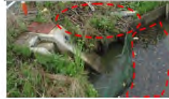
写真 35：取水部周辺の土砂やゴミの堆積
