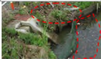
写真 34：取水部周辺の土砂やゴミの堆積
