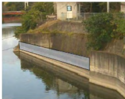
写真7：越流断面（青網掛け部分）
