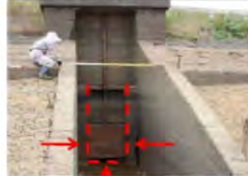
写真 34：ゲート周りの漏水
