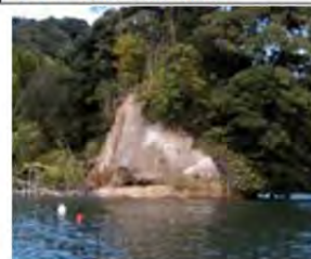
写真 37：貯水池斜面の崩落
