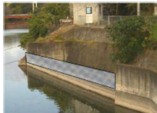
写真8：越流断面（青網掛け部分）
