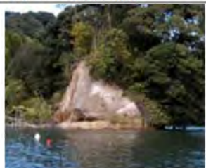
写真 36：ため池斜面の崩落
