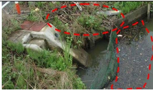
写真 35：取水部周辺の土砂やゴミの堆積
