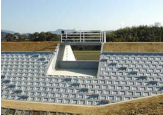
写真2：洪水吐 (香川県HPより)
