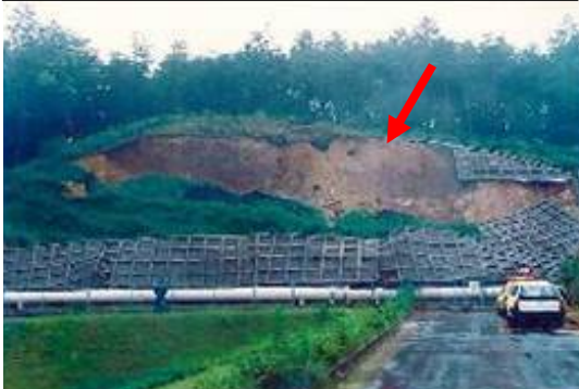
写真 38：堤体付近の法面(崩壊後)
