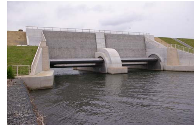
写真. 堤防との調和に配慮した水門の例① (旧北上川: 鴛波水門)
