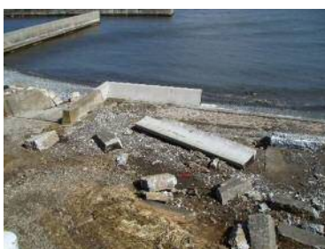
護岸の被災状況
