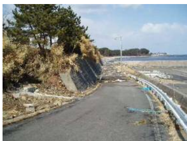
道路の被災状況
