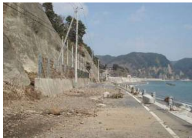
道路の被災状況
