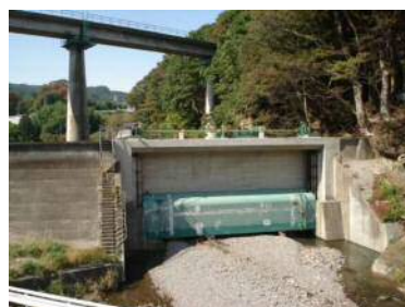
水門上屋の被災状況
