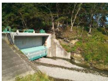
水門直下流の被災状況
