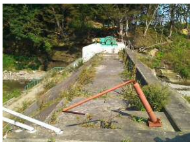
防潮堤の被災状況
