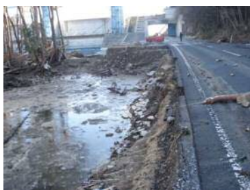
水門より上流側(右岸)の被災状況
