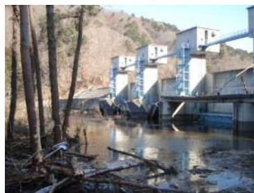
普代水門の被災状況
