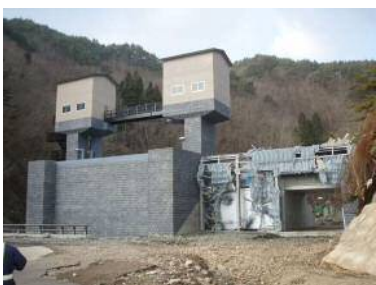
施工中の新設水門、陸閘の被災状況
