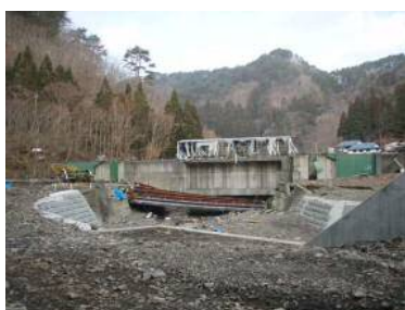
既設水門、陸閘の被災状況
