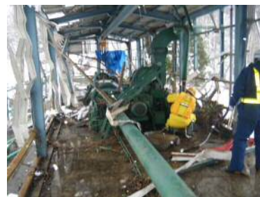
既設水門の被災状況
