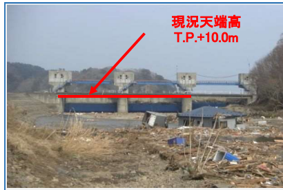
田代川水門被災・河道閉塞状況
