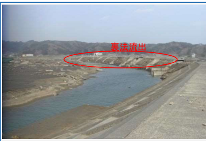
第一線堤被災状況 (水産庁所管堤防)
