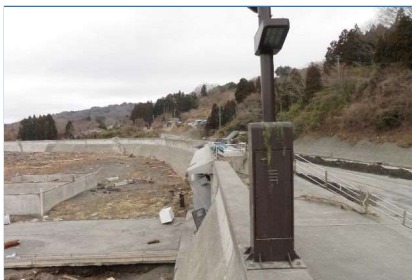
既存陸間付近の被災状況
