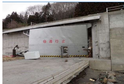
既存陸間の被災状況
