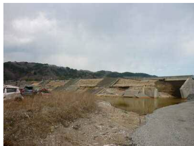
防潮堤の被災状況 (平成24年4月撮影)
