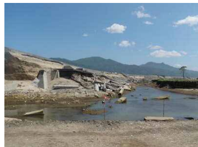
被災直後 (平成23年6月撮影)
