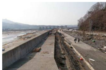
防潮堤の破損状況
