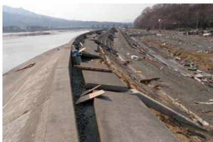
防潮堤の破損状況
