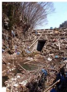
防潮堤裏側水門被災状況
