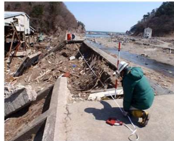
防潮堤被災状況
