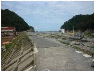
防潮堤被災状況
