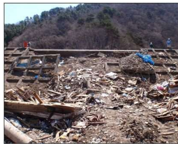
防潮堤法裏被災状況
