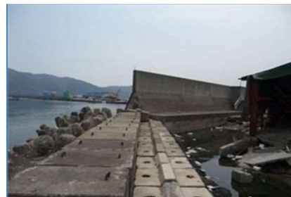
堤防の被災状況
