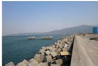
突堤の被災状況
