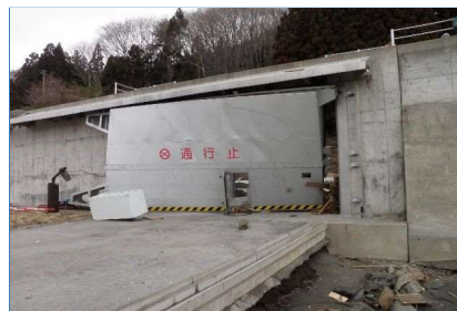
既存陸間の被災状況
