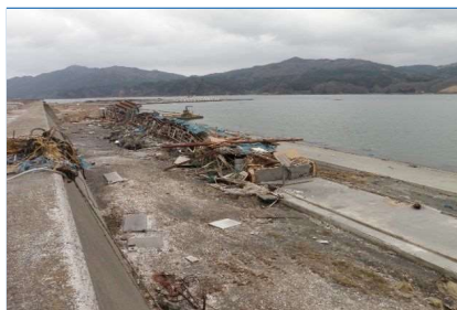
港湾内の被災状況
