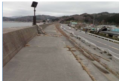
既存防潮堤背後の被災状況
