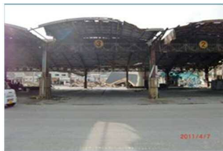
港湾内施設の被災状況
