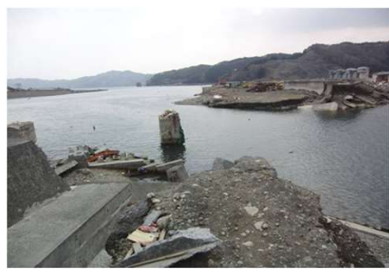
大槌川右岸 破堤地点
