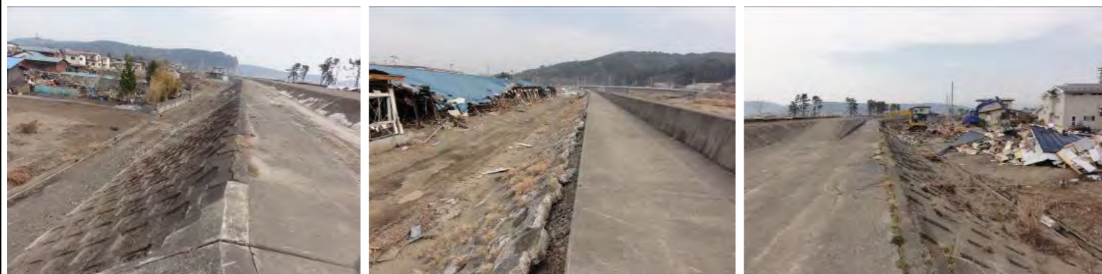
久慈湊漁港海岸の久慈川左岸の裏のり田津波の越流により損壊が見られる。裏側には損壊はない。背後地の家屋の損傷は一部全壊もあるが、その範囲は広くない。
