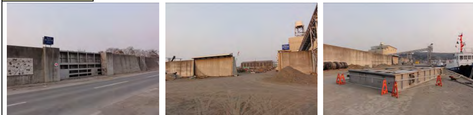
その他の門扉は大きな損傷は見られないが、南4号門扉は「走行不能」となっており、設備関係の損傷が見られる。
