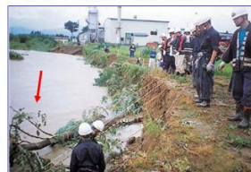
←滝名川の増水に伴う河岸欠陥及び水防活動の状況
