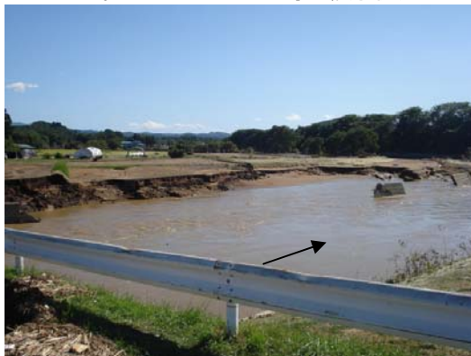
盛岡市田山役石花橋左岸の被災状況
