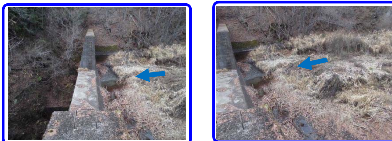
土石流発生後
