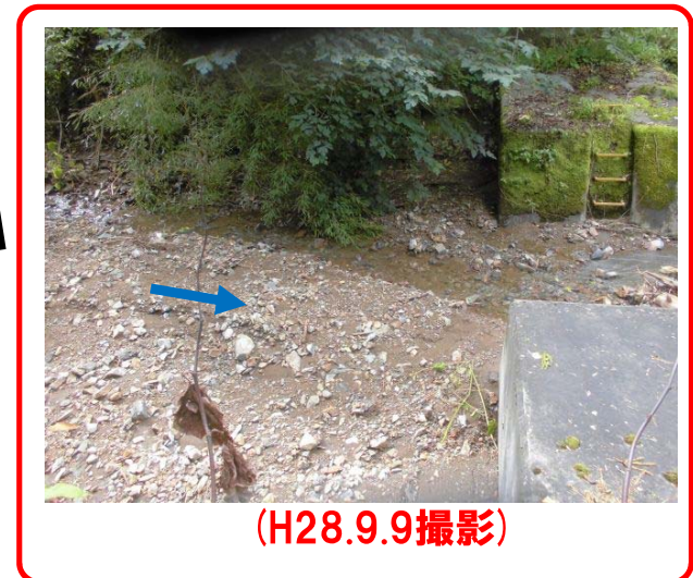
土石流発生後
