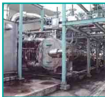
図 4-4 下水熱回収施設 (中川ポンプ場)
