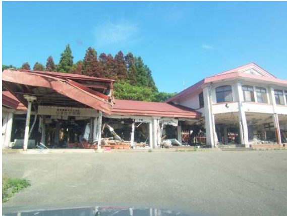
(被災した知的障がい者施設 (山田町))
